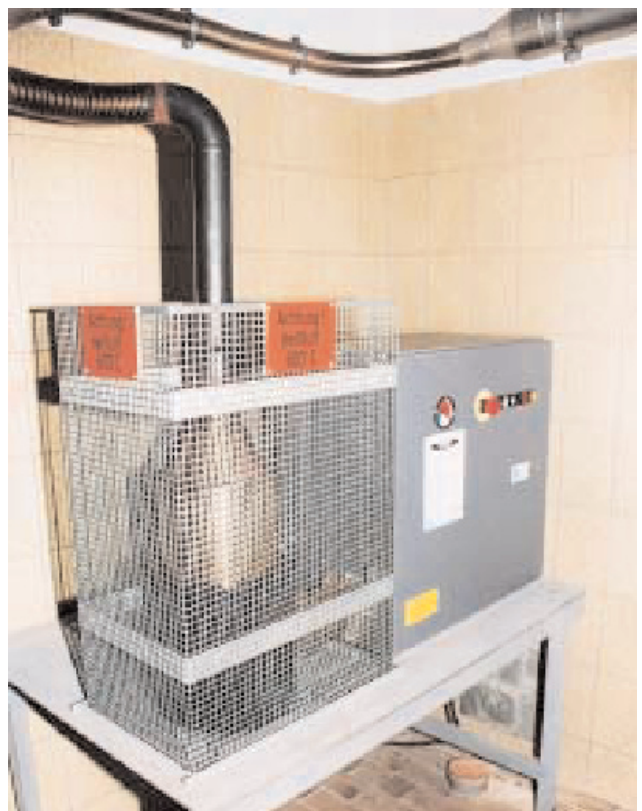
Abb. 4: In dieser Filterreinigungsanlage werden die Filtrückstände bei einer Temperatur von 600° C – 650° C mit Heißluft verbrannt.
