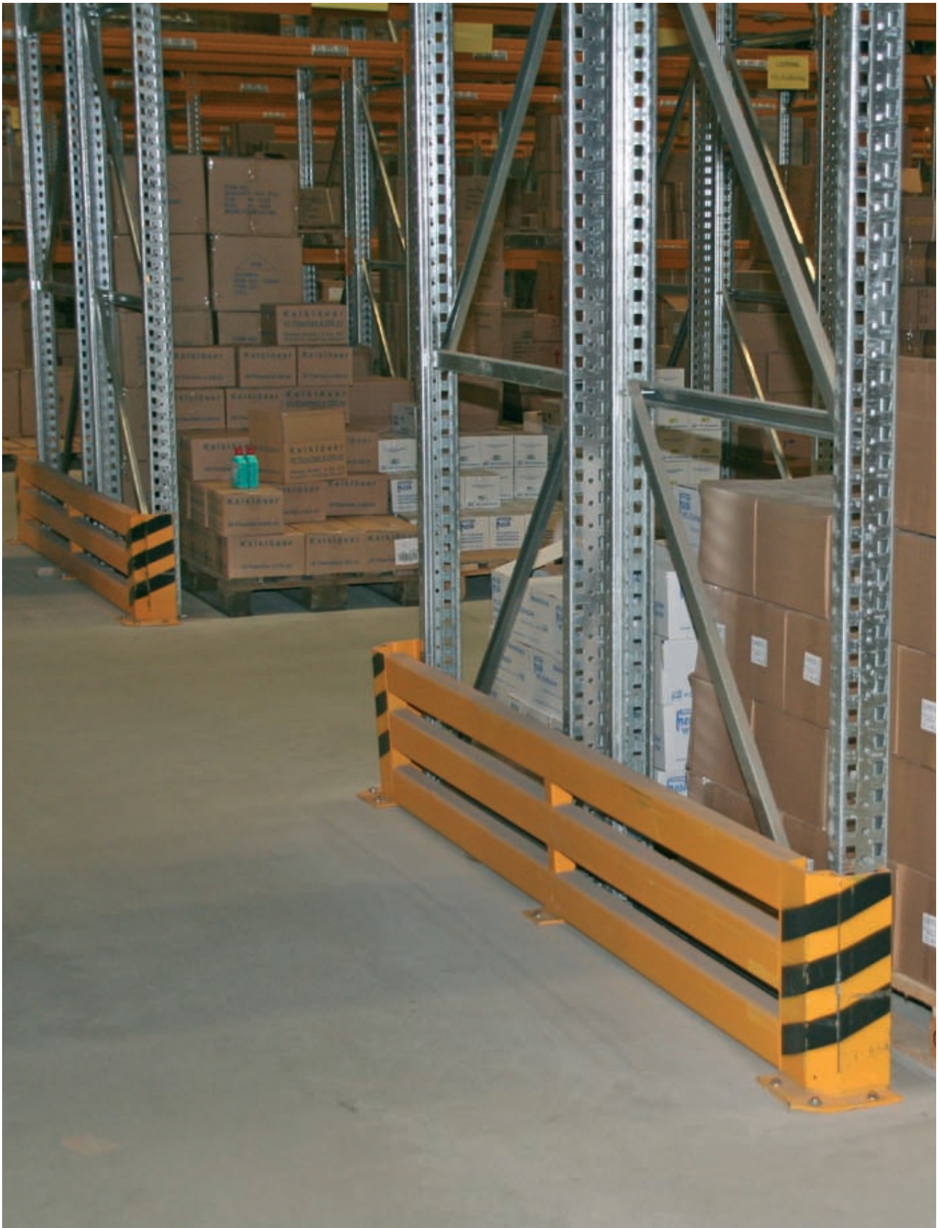
Bild 2: Regalanlage mit Anfahrerschutz vor den Eckstützen
