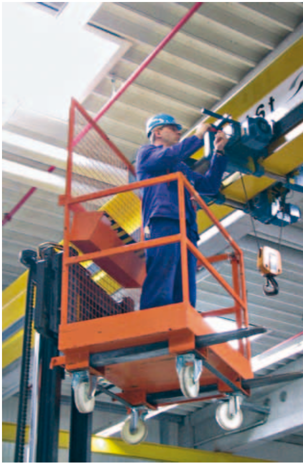
Mit Gabelstaplern sollte die Arbeitsbühne nicht höher als 5 m angehoben werden. Die Umwehrgung der Arbeitsbühne schützt die Person vor Absturzgefahren.
